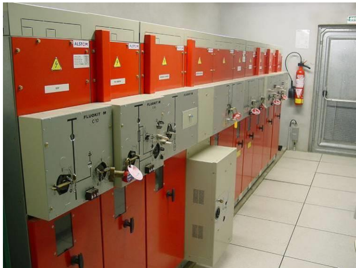
Intérieur d'un poste de livraison
