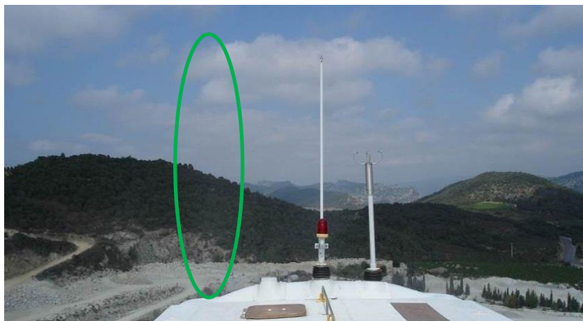
Figure 58 : Paratonnerre présent sur une éolienne de VALECO
