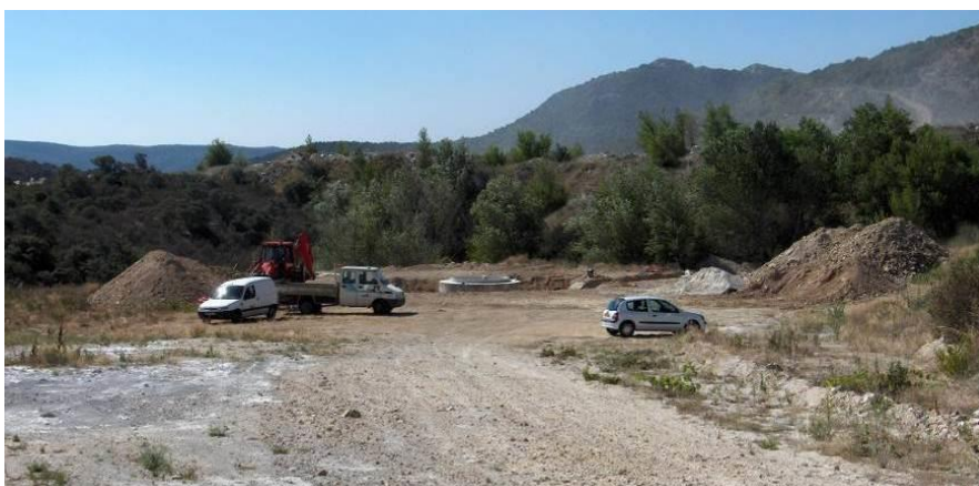
Figure 51 : Stockage des matériaux excavés en bordure de la plateforme à Saint Arnac (66).
